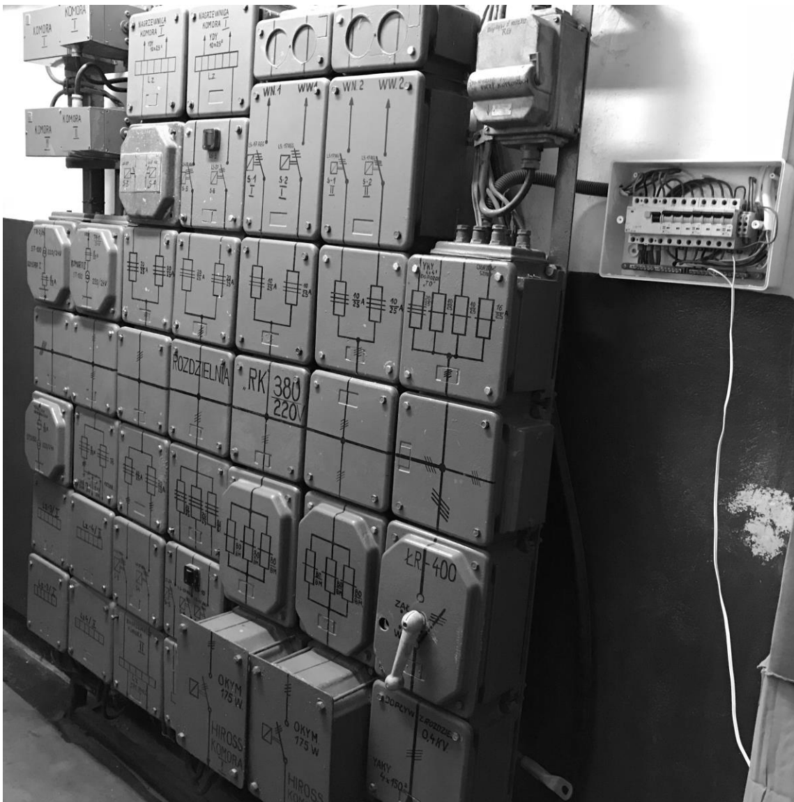
Zdjęcie nr 1 / Widok rozdzielnic elektrycznej RK
